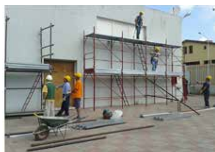
Figura 2. Formazione specifica di lavoratori addetti al montaggio, uso e smontaggio di un ponteggio (fonte: Ente Scuola Edile di Messina e Provincia, http://www.esemep.it/ )
